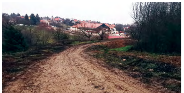
A Patakpart utca jelenlegi állapota. Utat kell építeni, de Budakalász egyedül ezt nem tudja kifizetni.
