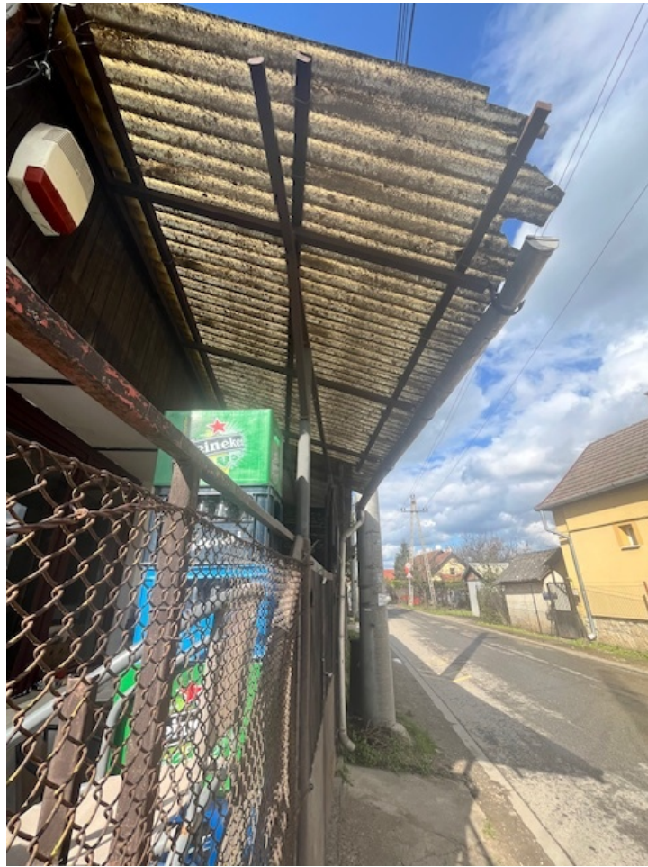
1619 hrsz ingatlan előtti előtető túlnyúlás
